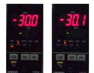
温度調節器 1～温度調節器 6
